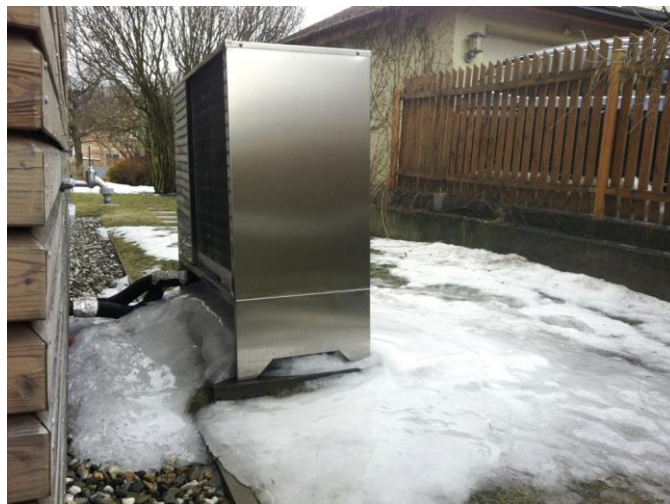
Obr. č. 7 Příklad vzniku vrstvy ledu z kondenzátu kolem venkovní jednotky
